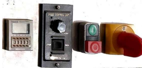
شکل ۶. کلیدها، واحد کنترل سرعت و تایمر دستگاه
