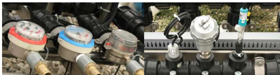
شکل ۵: فلومتر و سنسورهای به کار رفته در سیستم
