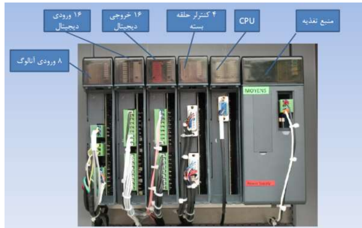
شکل ۶: نمای کلی PLC
