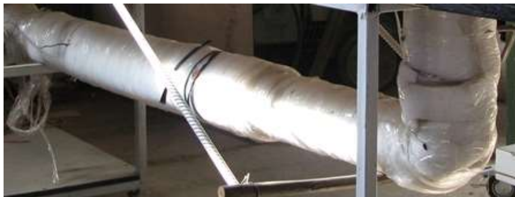
شکل ۲. لوله عایق بندی شده برای انتقال هوای گرم
