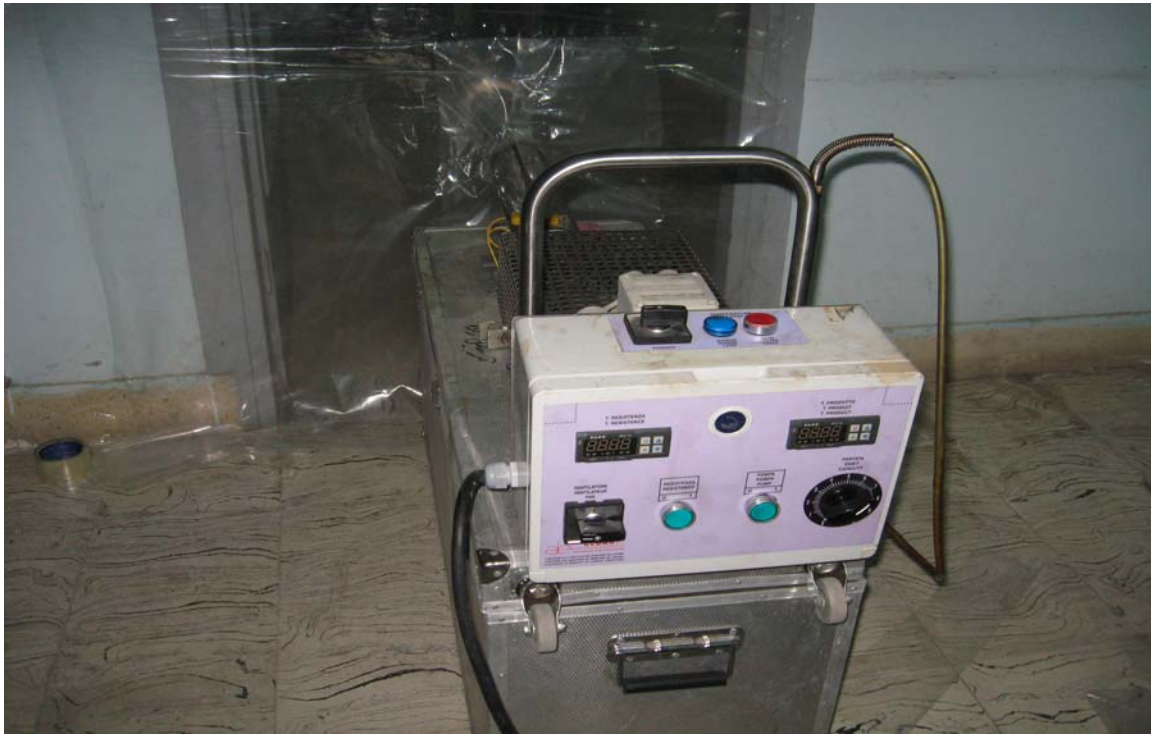
شکل ۱: دستگاه الکتروفاگر (مه پاش) در حالت نصب برای مه پاشی از بیرون سردخانه
