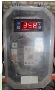
شکل ۵. واحد کنترل و مانیتورینگ
