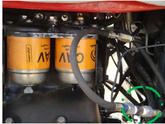
شکل ۳. محل نصب حسگر سوخت سنج.
