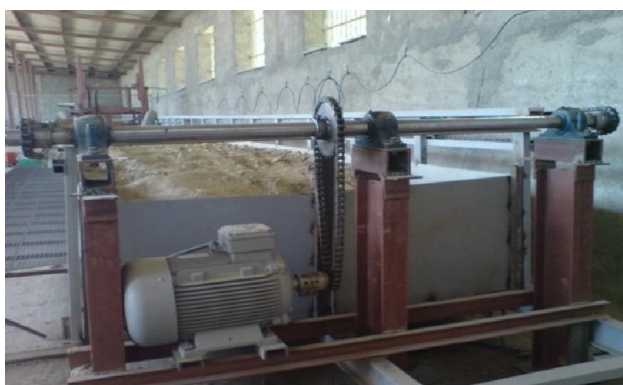
شکل ۳- مجموعه محرک و سیستم انتقال نصب شده بر روی سویل بین
