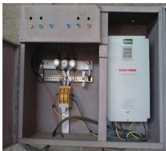
شکل ۴: نمایی از تابلو برق و اینورتر مجموعه
