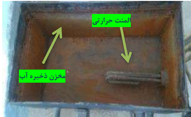
شکل ۹- مخزن آب گرم جهت گرم کردن هاضم
